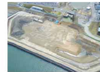
施工実績 発注者：国土交通省 東北地方整備局 用途：地盤改良 竣工年：2017年 所在地：宮城県
